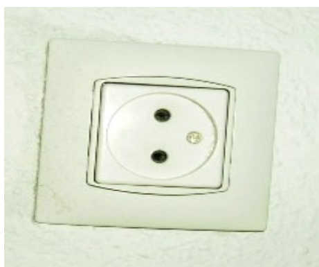
Toma de corriente sin toma de tierra
